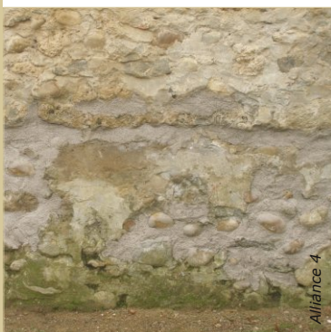
Reprise du mur avec des galets et un mortier de chaux NHL2/sable. La consolidation du support est une phase importante de la préparation.
