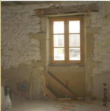
Préparation de cet ancien mur en pierre : gobetis avant application d'un enduit chaux/chanvre + rupture thermique en béton de chanvre sous la fenêtre + enduit chaux/ponce sur le soubassement agissant comme tampon hygrométrique.
