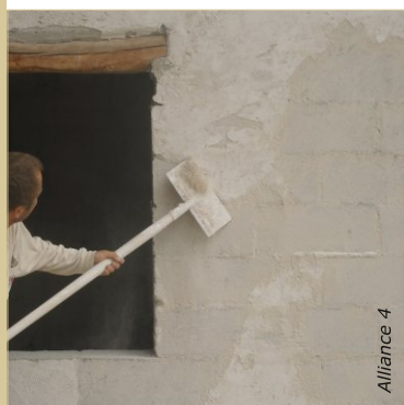
Gratter les enduits anciens dont la tenue est mauvaise. Sur le bâti ancien, retirer si possible les revêtements à base de ciment ou de résine.
