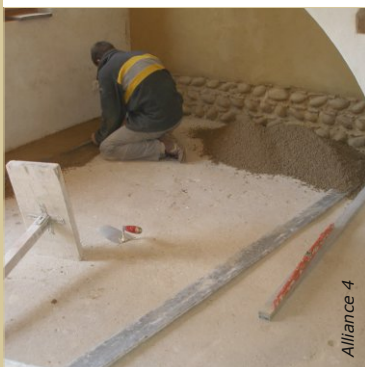
Commencer par tirer des nus le long des murs : ces bordures maçonnées servent de niveau pour tirer la partie centrale.
