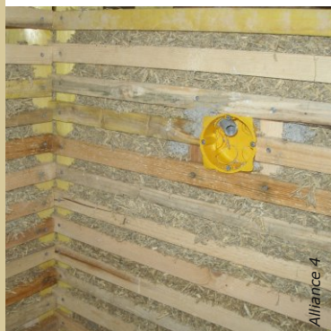
Les réseaux techniques sont noyés dans le remplissage végétal. Il convient d'isoler les appareillages électriques avec du mortier.
