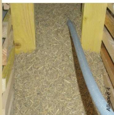
Le réseau électrique est positionné, le plus possible, du côté extérieur, loin des habitants.
