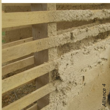
La projection mécanique au sablon garantit une bonne accroche de l'enduit entre et sur les lattes.
