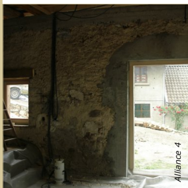
Avant : ponts thermiques autour des fenêtres, gaines et boîtiers électriques apparents, support disparate.
