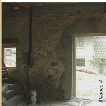
Avant : ponts thermiques autour des menuiseries, gaines et boîtes électriques apparentes, support disparate.
