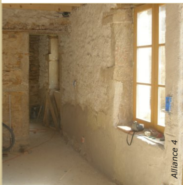
Les préparations pour ce support ancien en pierre sont : consolidation du soubassement avec un mortier de chaux NHL2, gobetis sur la partie haute et scellement des boîtes au mortier de chaux.
