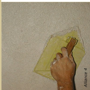
Le talochage est un mouvement circulaire bien appuyé. Il permet de donner la plânerie en égalisant les creux et bosses.
