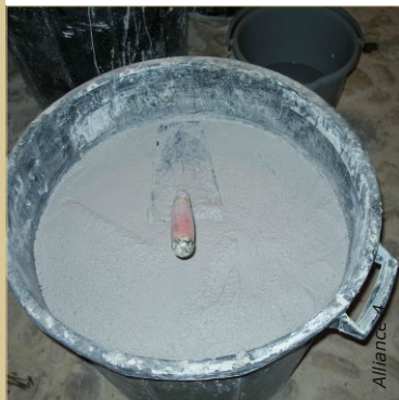
Les mortiers de chaux aérienne sont préparés au moins la veille de leur utilisation, puis stockés sous un voile d'eau.
