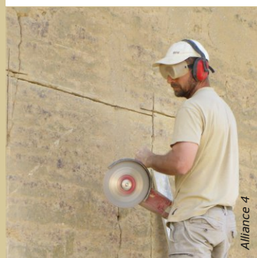
L'utilisation de machines de chantier présentent des risques pour la santé.
