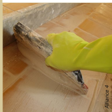
Les gants épais à longue manchette sont obligatoires lors du contact alterné d'eau et de mortier de chaux, notamment lors de la pose des carreaux de terre cuite.
