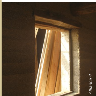
Une planche ou une poutre sert de linteau de fenêtre. Une feuillure d'environ 2 cm est prévue pour la pose de la fenêtre.
