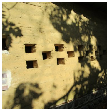
Le motif ajouré apporte lumière naturelle et ventilation à ce cabanon de jardin.
